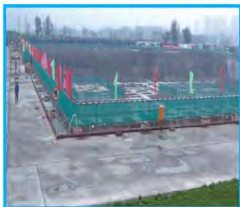
■ 基坑临边防护示例一
