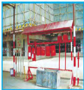
作业区配备消防器材示例
