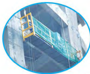
电动吊篮示例二
