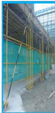
安全通道口防护棚示例三
