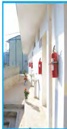
办公区配备消防器材示例
