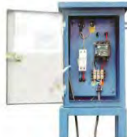
照明开关箱示例
